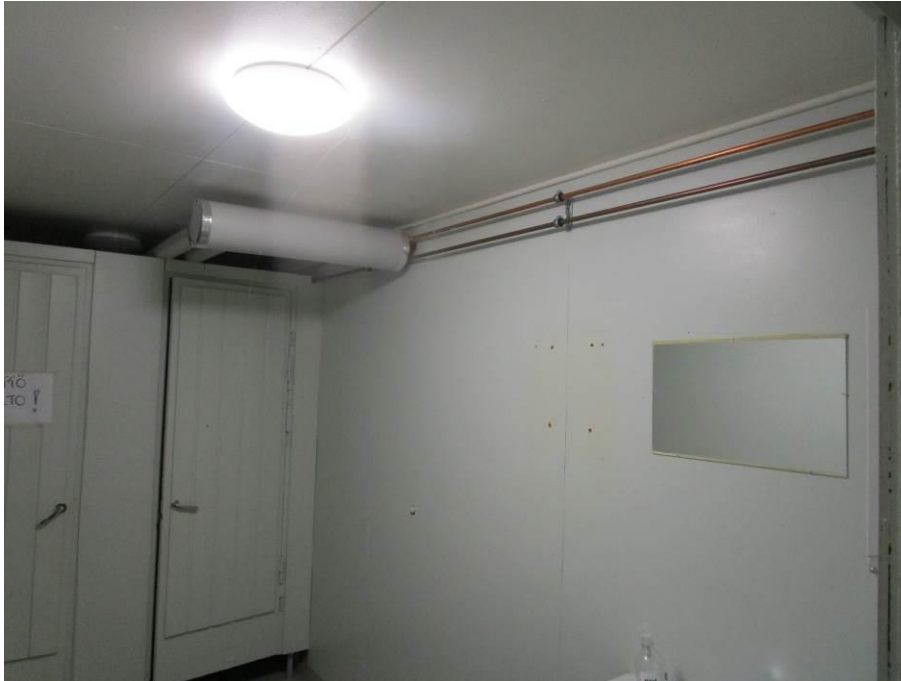
Kuva 56. Pinnassa kulkevia kuparisia käyttövesiputkia
