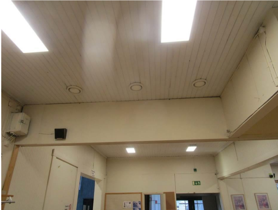
Kuva 66. Eteistilan katossa olevia poistoilmaventtiileitä
