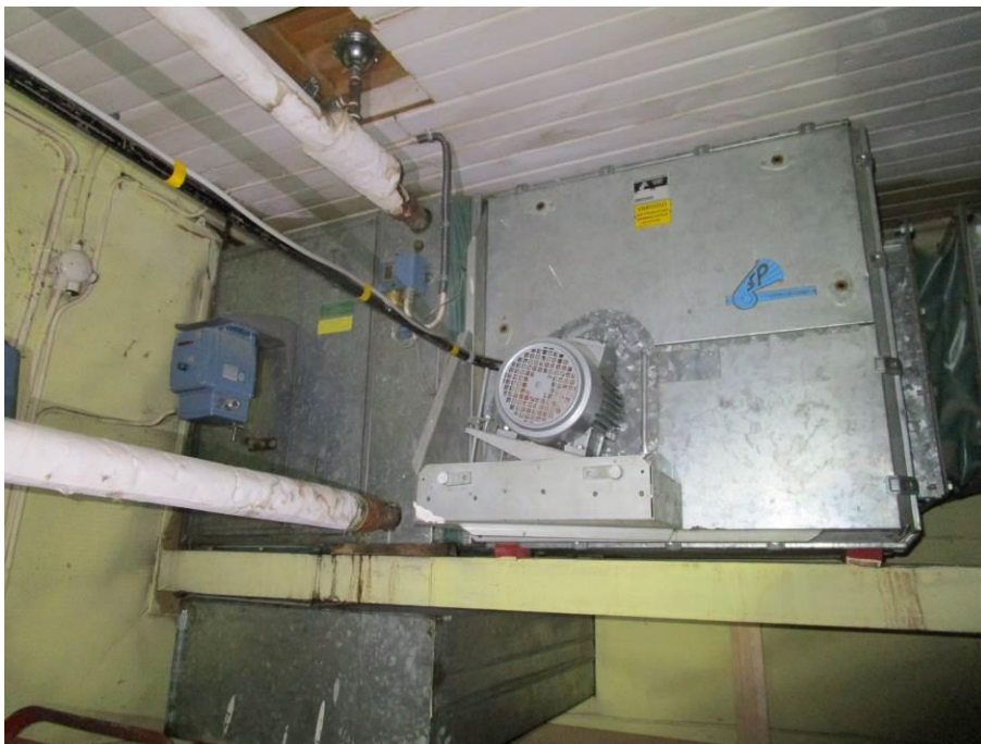
Kuva 60. Alkuperäisen osan tuloilmakone
