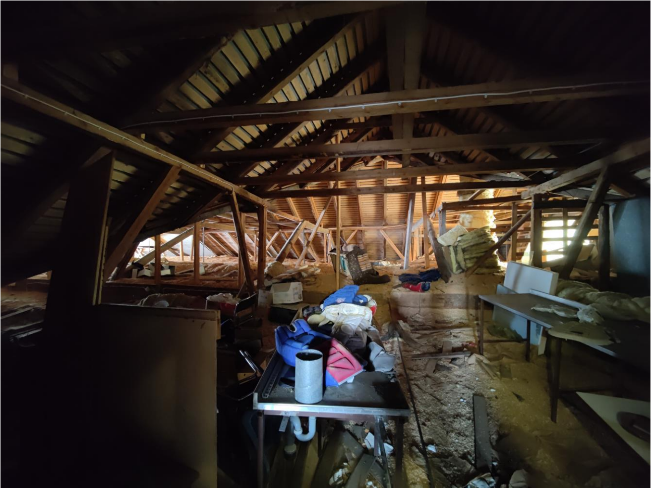
Kuva 3. Yleisnäkymää ullakolle. Ullakolla oli todella paljon tavaraa, mikä vaikeutti liikkumista. Eristys oli pääosin purua.
