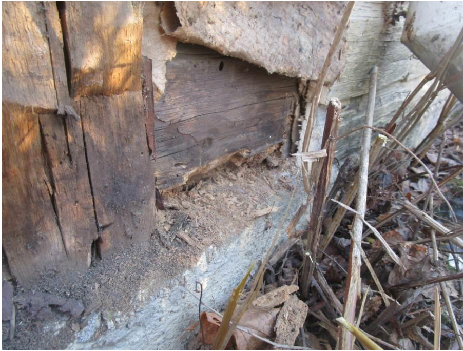
Kuva 17. Lahovaurioita alimmassa hirsikerrassa.
