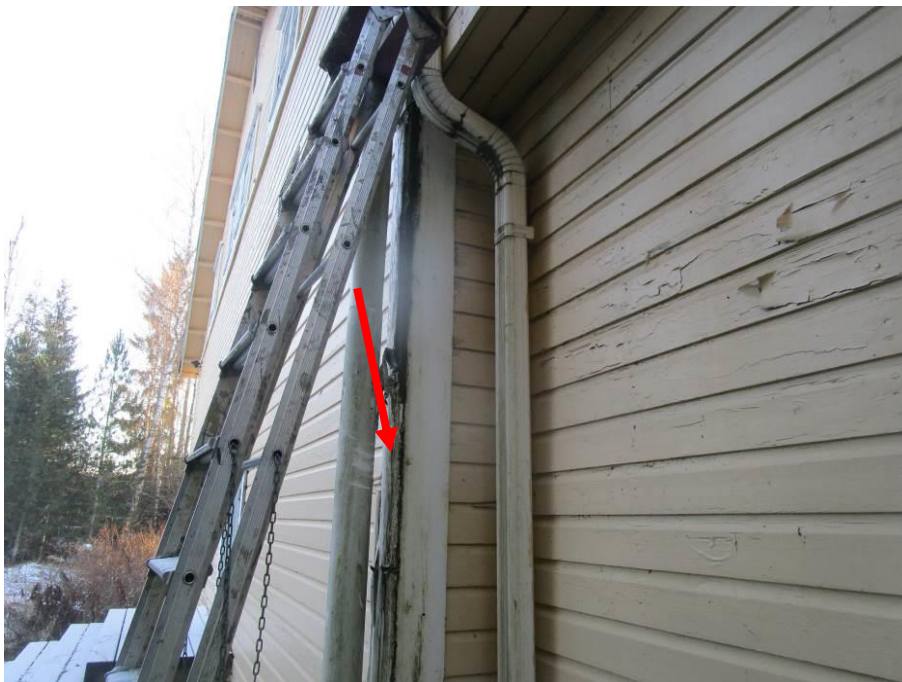
Kuva 28. Nurkkalautoitus on vaurioitunut vanhan ja uuden liittymästä.
