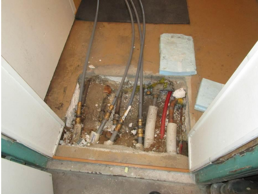
Kuva 50. Alkuperäiseen osaan meneviä lämmitysputkistoja
