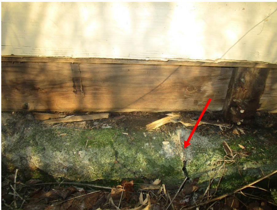
Kuva 20. Sokkeli on halki.
