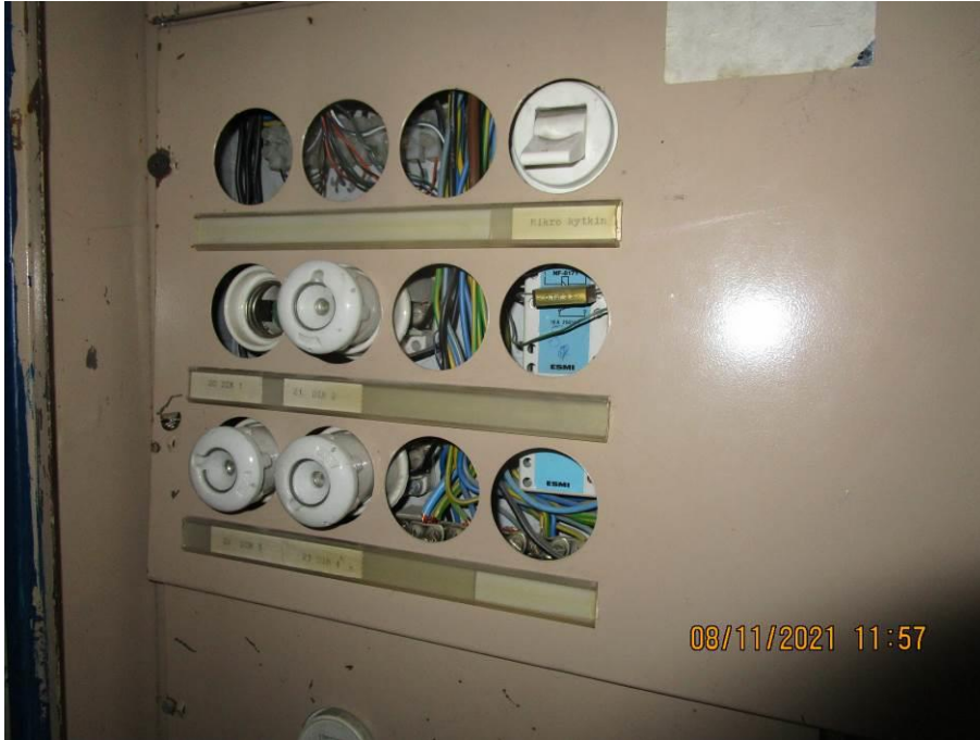
Kuva 71. DJ-kopin keskuksessa suojaamattomia sulakekansiaukkoja
