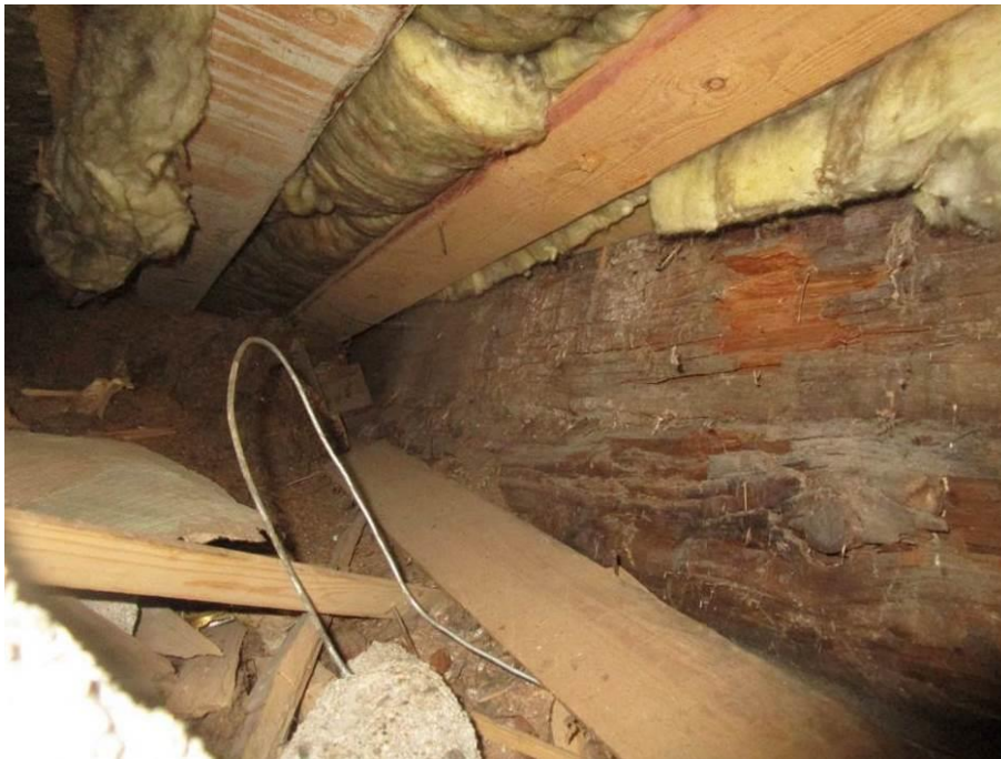
Kuva 12. Hirren pinta lahovaurioitunut.
